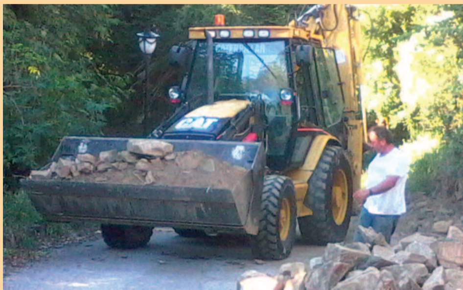
Ο Πρόεδρος της Τοπικής Κοινότητας Γιάννης Καρπούζης χειρίζεται τον εκσκαφέα. Δεξιά ο Τοπικός Σύμβουλος Βασίλης Καρπούζης.
